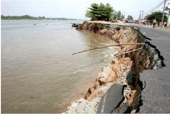
Hình 1. Sạt lở đường giao thông ven sông khu vực TP. Hồ Chí Minh [3].
