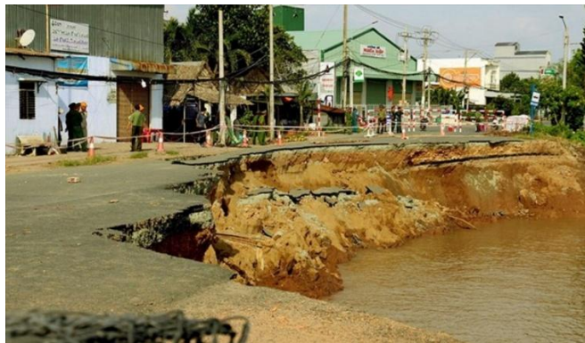
Hình 2. Nguy cơ xâm nhập mặn và sạt lở ảnh hưởng trực tiếp đến cơ sở hạ tầng giao thông tại Tây Nam Bộ [5].
