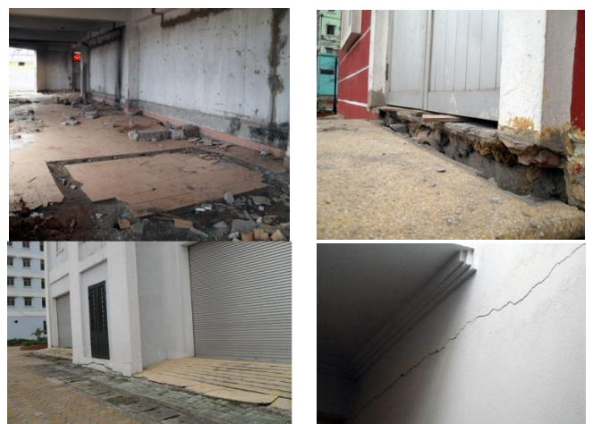
Hình 1. Hình ảnh lún móng và nứt nền tại các khu chung cư tái định cư.
