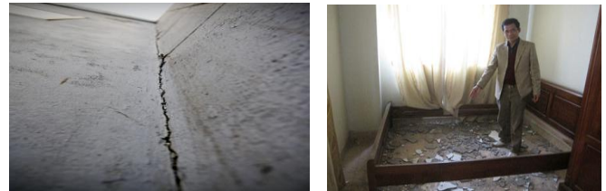
Hình 2. Hình ảnh bong tróc gạch và nứt tường tại các khu chung cư tái định cư.
