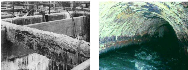
Hình 1. Sự ăn mòn sun phát trong một số công trình xây dựng ngầm và ngập mặn ở Việt Nam.
