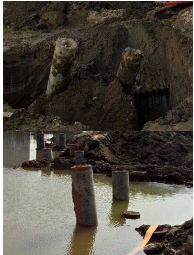
Hình 1.7. Sự cố cọc bị xô nghiêng do máy ép lớn làm đất nền dịch chuyển.
