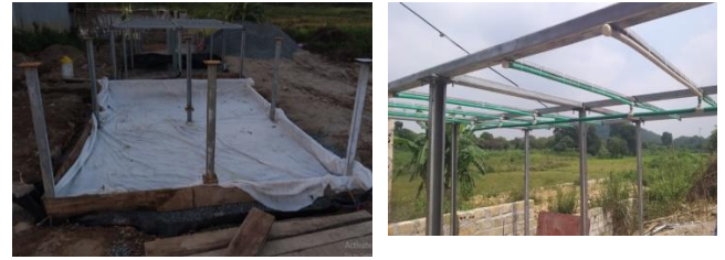
Hình 8. Ô thử nghiệm kết cấu mặt đường bê tông xi măng rỗng thoát nước và mô hình mưa nhân tạo.
