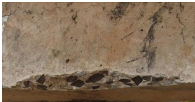
Hình 10. Sàn BTCT bị vỡ tại góc sau thí nghiệm cháy
