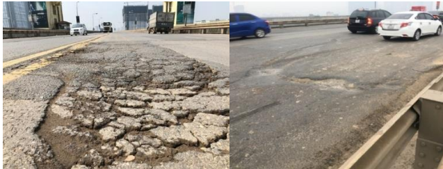
Hình 2. Hiện trạng hư hỏng mặt cầu trước khi sửa chữa.
