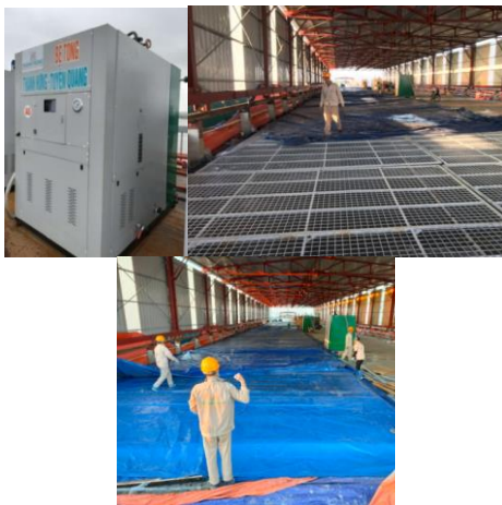
Hình 22. Nồi hơi và buồng bảo dưỡng nhiệt ẩm lớp phủ UHPC.
