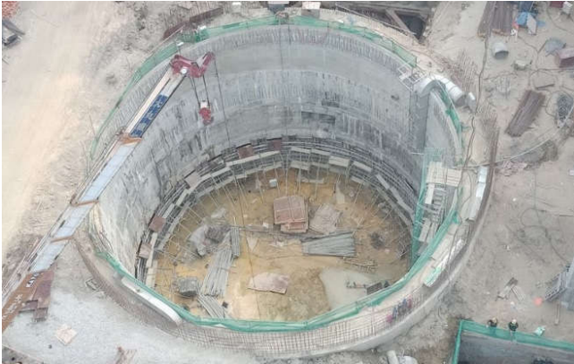
Hình 1.2 – Bể lắng xoáy thuộc Nhà máy Cán thép QSP
