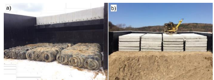
Hình 12. Đắp móng cầu Sielnica, Ba Lan: a) lớp kiện lớp đầu tiên được đặt phía sau tường sau; b) gia tải kiện lớp [14].
