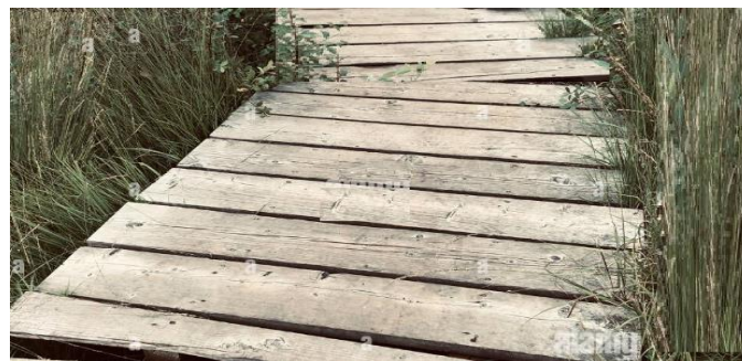
Hình 7. Cây cầu với các tấm gỗ lát có khe hở để thoát nước.
