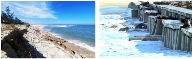
Hình 1. Sạt lở gia cố bờ biển tại Tam Thanh, TP.Tam Kỳ, Quảng Nam.
