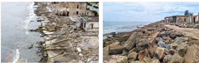
Hình 3. Kè biển Nam Định bị sạt lở.
