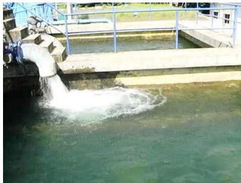
Hình 3. Bể nước sạch Phở Yên-tỉnh Thái Nguyên.
