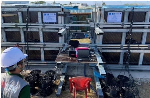
Hình 7. Bộ thu nhận tín hiệu đa kênh NI9219 kết nối với các cảm biến được lắp đặt tại các vị trí khác nhau trong hai khối đổ M0 và M1 tại hiện trường.
