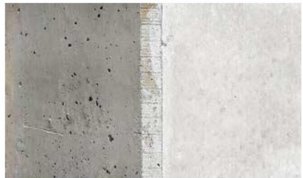
Hình 4. Bề mặt bê tông đúc và không đúc với vải hỗ trợ ván khuôn.
