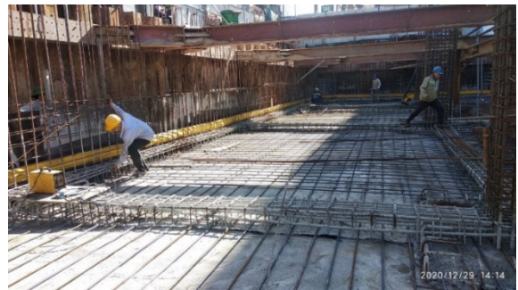
Hình 2. Hình ảnh thi công tầng hầm công trình “Trụ sở Bảo Hiểm Tiền gửi Đà Nẵng”.
