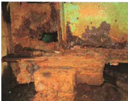
Hình 1. Hư hại dầm thép ở khu vực đầu cầu do ăn mòn.
