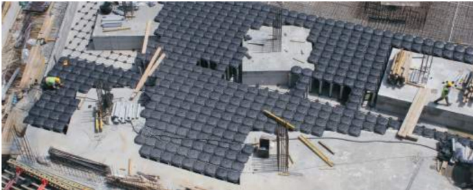
Hình 2.4. Dự án Istanbul Tower – Istanbul, Thổ Nhĩ Kỳ Lắp khoảng trống giữa móng.
