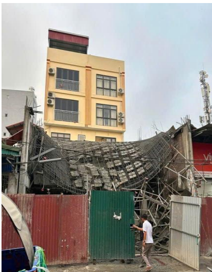
Hình 2. Hình ảnh công trình sập ván khuôn khi thi công sàn VRO.
